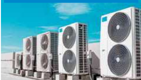
BOMBAS Y VENTILADORES
