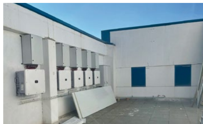
Inversores instalados de la marca HUAWEI, de inyección trifásica 3 x 400 V y 50 Hz sin transformador.
